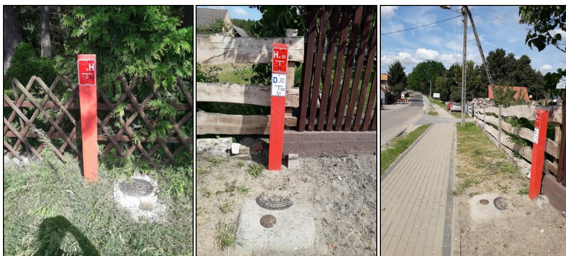
Fot. 4. Sieci wodociagowe przeciwpowozarowe z hydrantami zewnetrznymi przeciwpowozarowymi.
