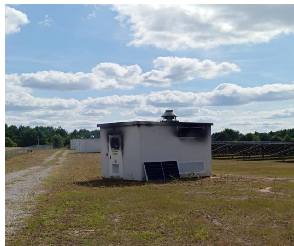
Fot. 33. Pożar transformatora w Osińcu
