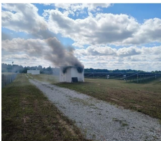
Fot. 32. Pożar transformatora w Osińcu
