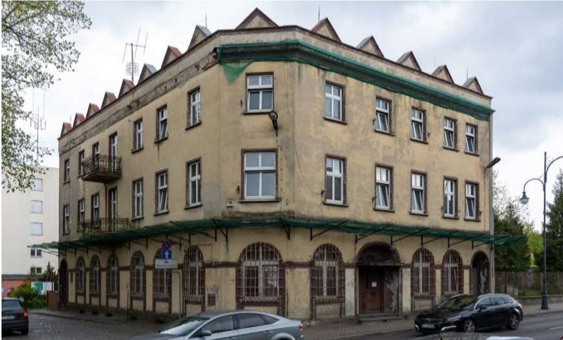
Rysunek 4. Stan techniczny budynku po byłym banku.
