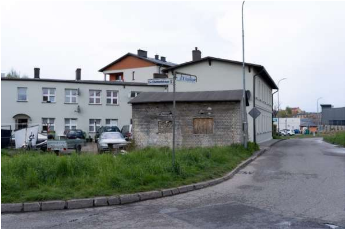
Rysunek 4. Stan techniczny budynku po byłym banku.
